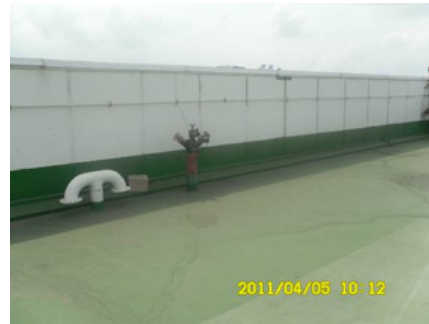
ระบบหัวจ่ายน้ำดับเพลิงบนดาดฟ้า
