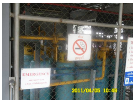
โครงสร้างห้องเก็บก๊าซหุงต้ม
