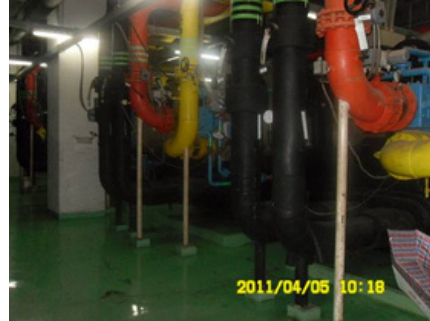
ท่อระบบปรับอากาศ
