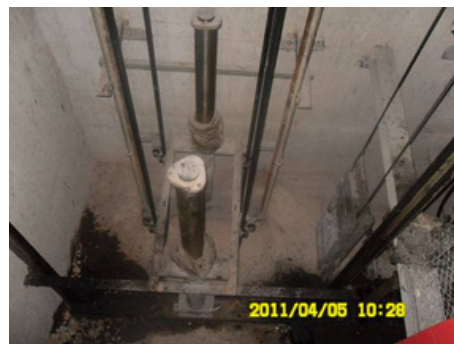
สภาพทั่วไปห้องเครื่องลิฟต์
