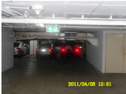
ท่อระบบน้ำชั้นใต้ดิน
