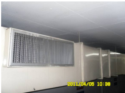
ท่อระบบท่อขึ้นจอดรถ
