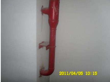
ท่อระบบน้ำดับเพลิง
