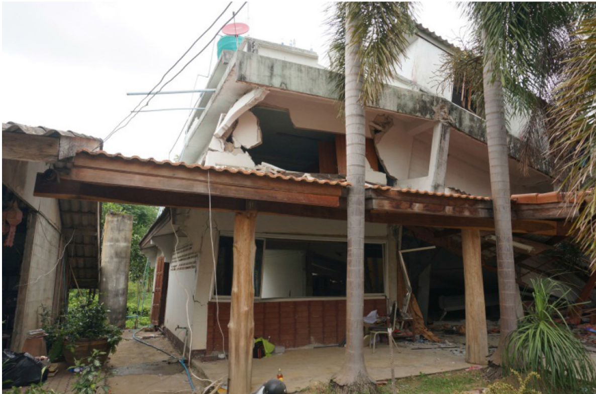
รูปที่ 2 ความเสียหายของอาคารบ้านเรือนจากเหตุการณ์แผ่นดินไหว ในจังหวัดเชียงราย เมื่อวันที่ 5 พฤษภาคม 2557
