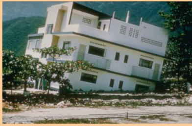
อาคารที่ได้รับความเสียหาย จากปรากฏการณ์ทรายเหลว ( ที่มา : NGDC )
