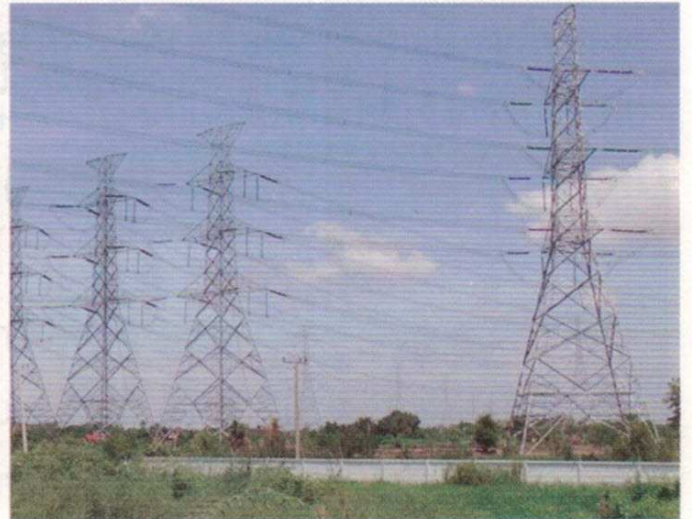
เสาไฟฟ้า
